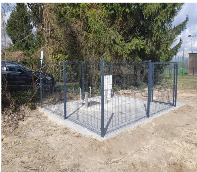
Fot. Pompowania ścieków w m. Kijany, gm. Spiczyn
